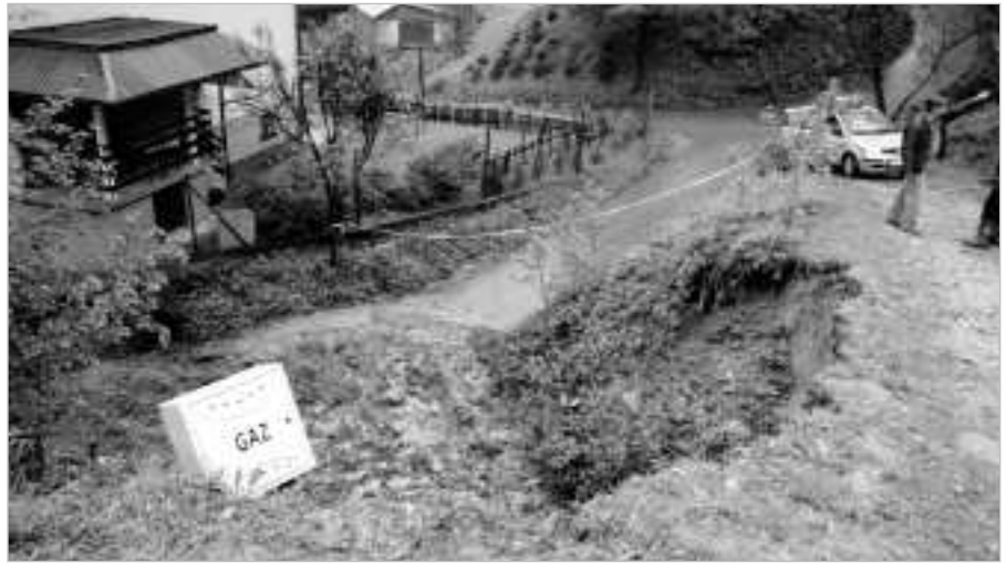
Uszkodzona droga i sieć gazowa. Fot. Dorota Gabryl
